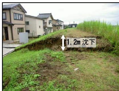
写真2 鯖石川新河道堤防の沈下 (柏崎地域振興局提供)
