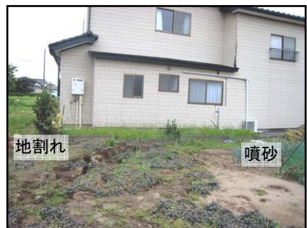
写真3 住宅地内の地割れと噴砂痕
