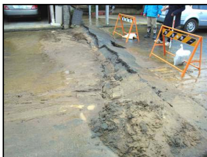
写真1 道路の盛り上がりや噴砂痕
