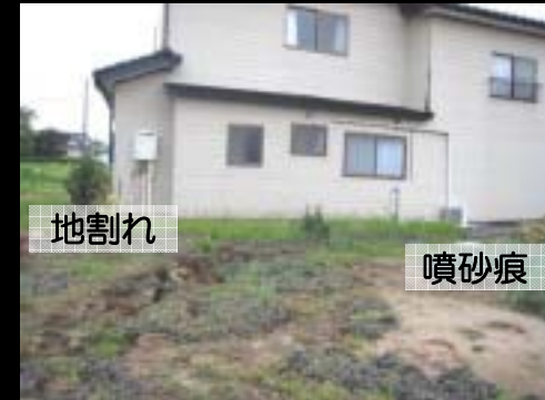
写真4 住宅地内の地割れと噴砂痕
