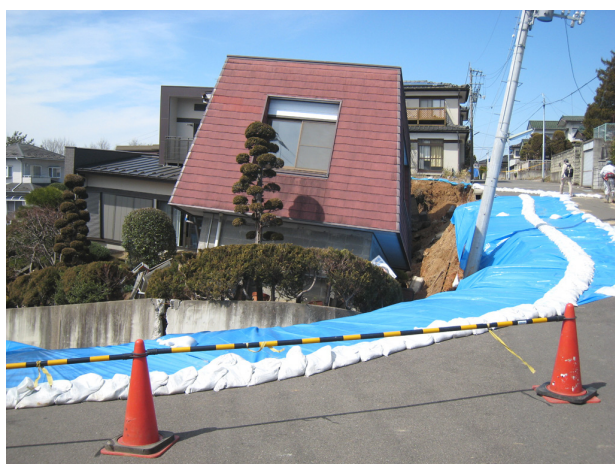
写真4.2-7 No.2の崩壊の上部
