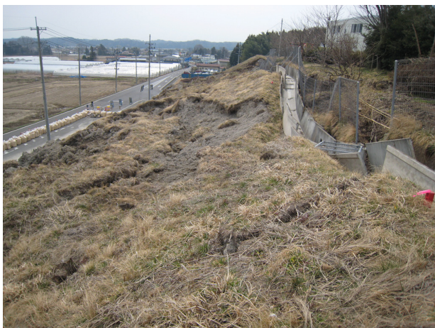
写真4.5-1 No.1の盛土被害
