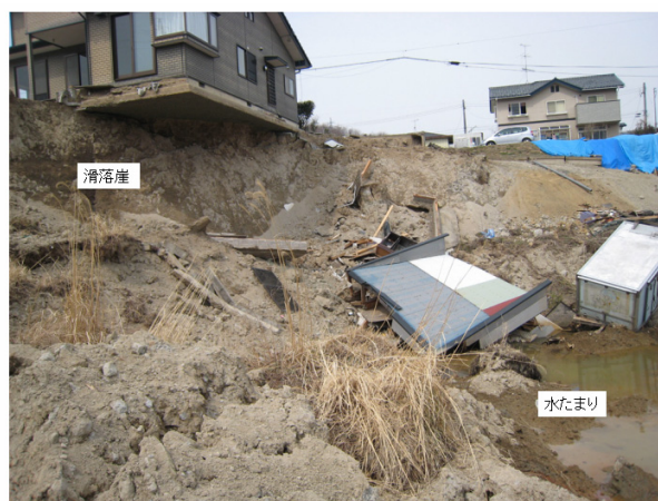
写真4.3-3 滑落崖の下に現れた水たまり
