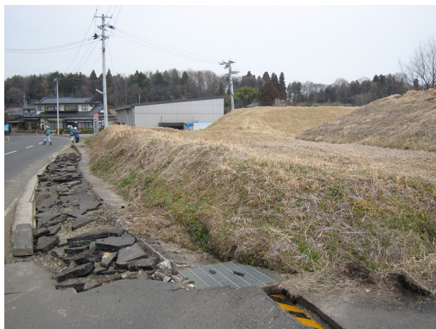
写真4.5-4 No.3の盛土被害
