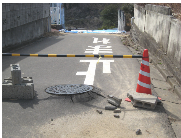
写真4.2-4 崩壊地後方のマンホール
