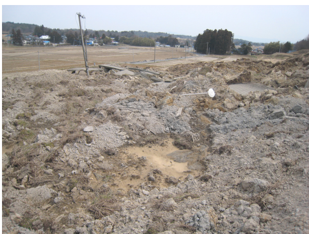
写真4.5-3 No.2の盛土被害（崩壊上部から）
