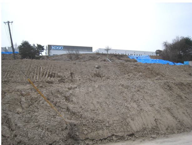
写真4.5-2 No.2の盛土被害（崩壊下部から）
