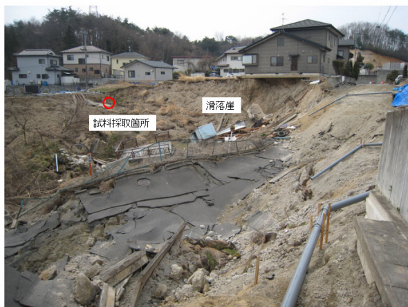
写真4.3-1 木之崎の宅地の崩壊全景
