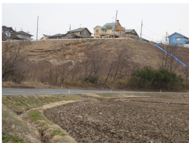
写真4.5-5 新白河南湖ニュータウンの盛土被害
