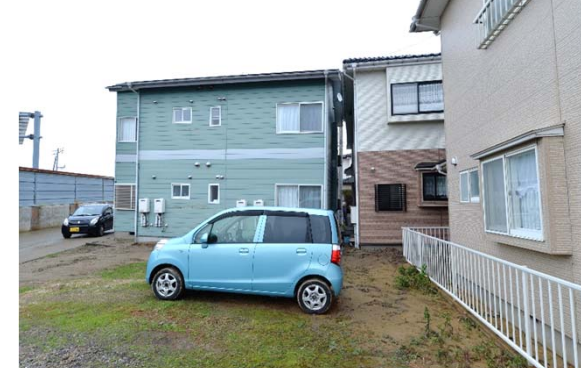
家屋の傾動・沈下（1/3善久）
