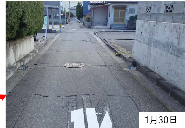
緩勾配砂丘斜面内の路面横断亀裂 水平変位や下部の隆起は小さい
