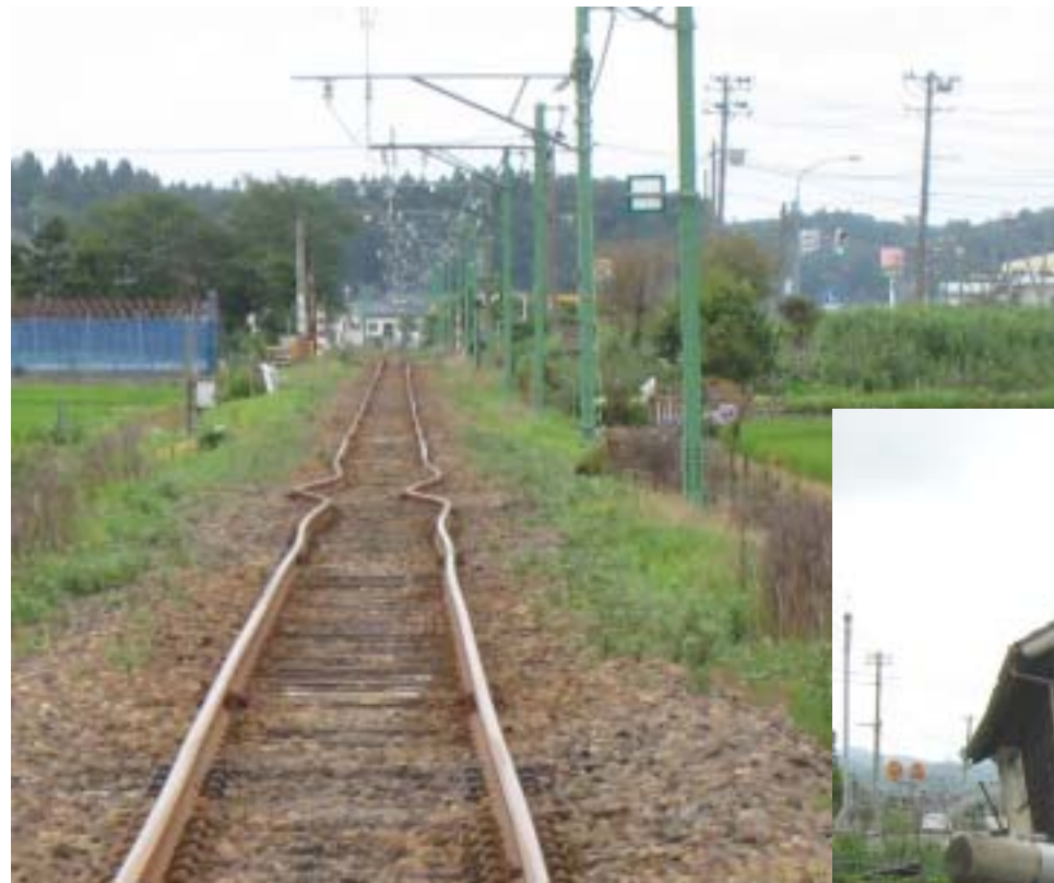
線路の曲がり
