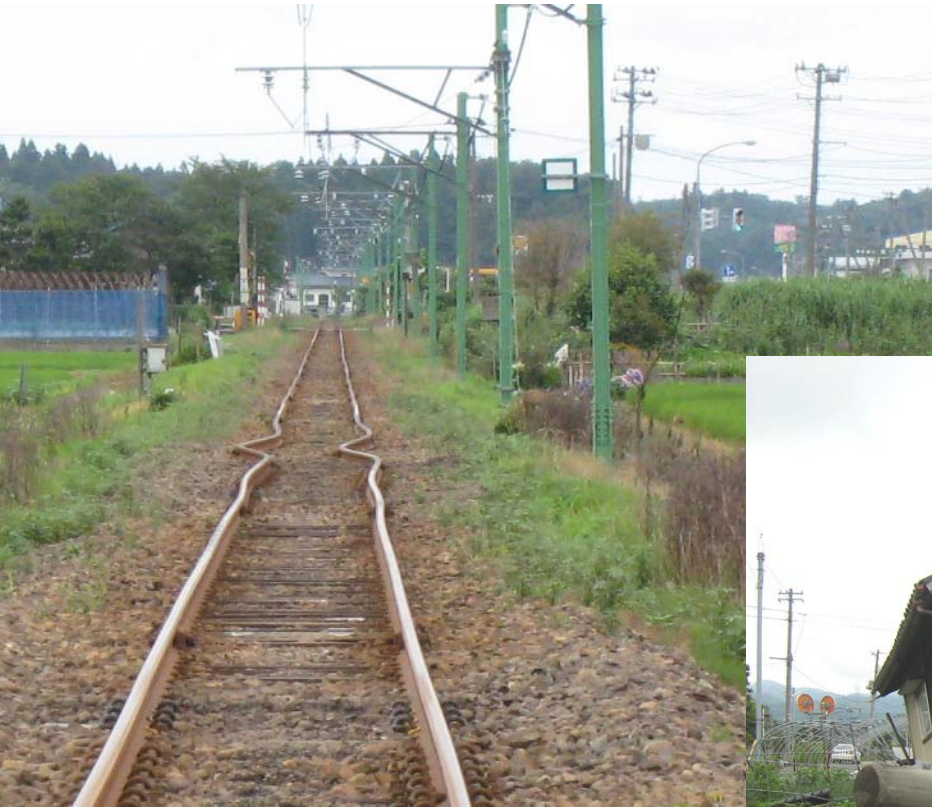
線路の曲がり
