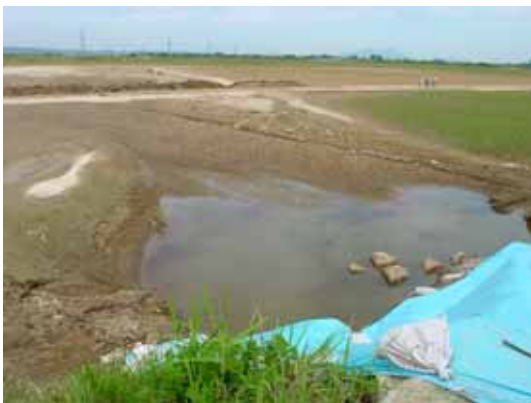
口絵 5-14 猿橋川破堤箇所の堤内地側
