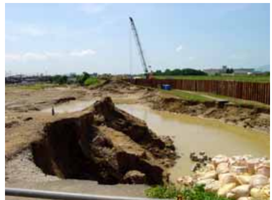
口絵 5-4 破堤点に残る大きくえぐられた跡
