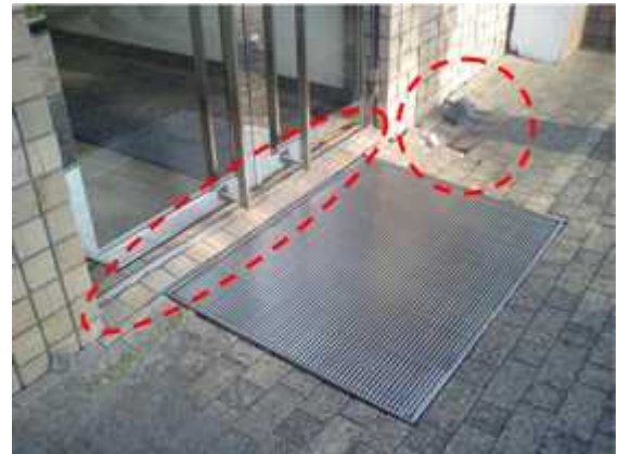
Fig.3.1 広川町役場周辺の地盤変状
